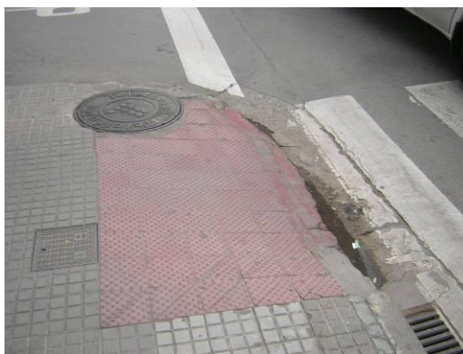
Imatge 10: deteriorament d'un gual per a vianants. Barri de l'Eixample.
