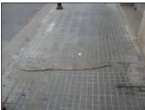
Fig. 31. Paviment en mal estat al carrer del metge Carreras. Font: elaboració pròpia
